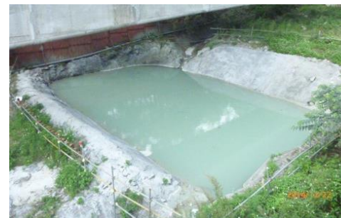
臨時滯洪沉砂池
