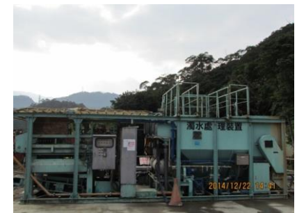
污水處理設備
